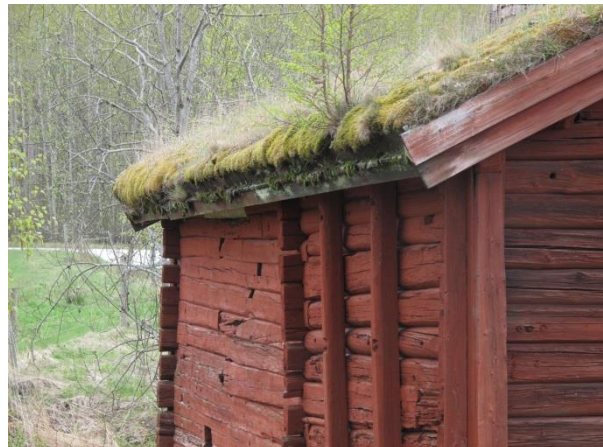
Takfoten på norra sidan var kraftigt rötskadad. Torven bestod till större delen av mossa. Här växte även mindre träd.
