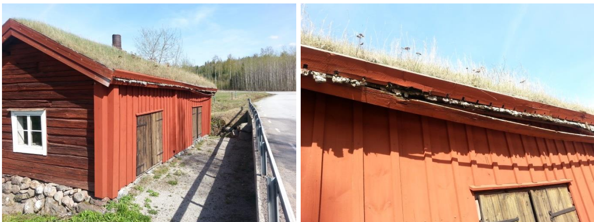
Takfoten på smedjan är i dåligt skick och mullåsen kraftigt rötskadad.
