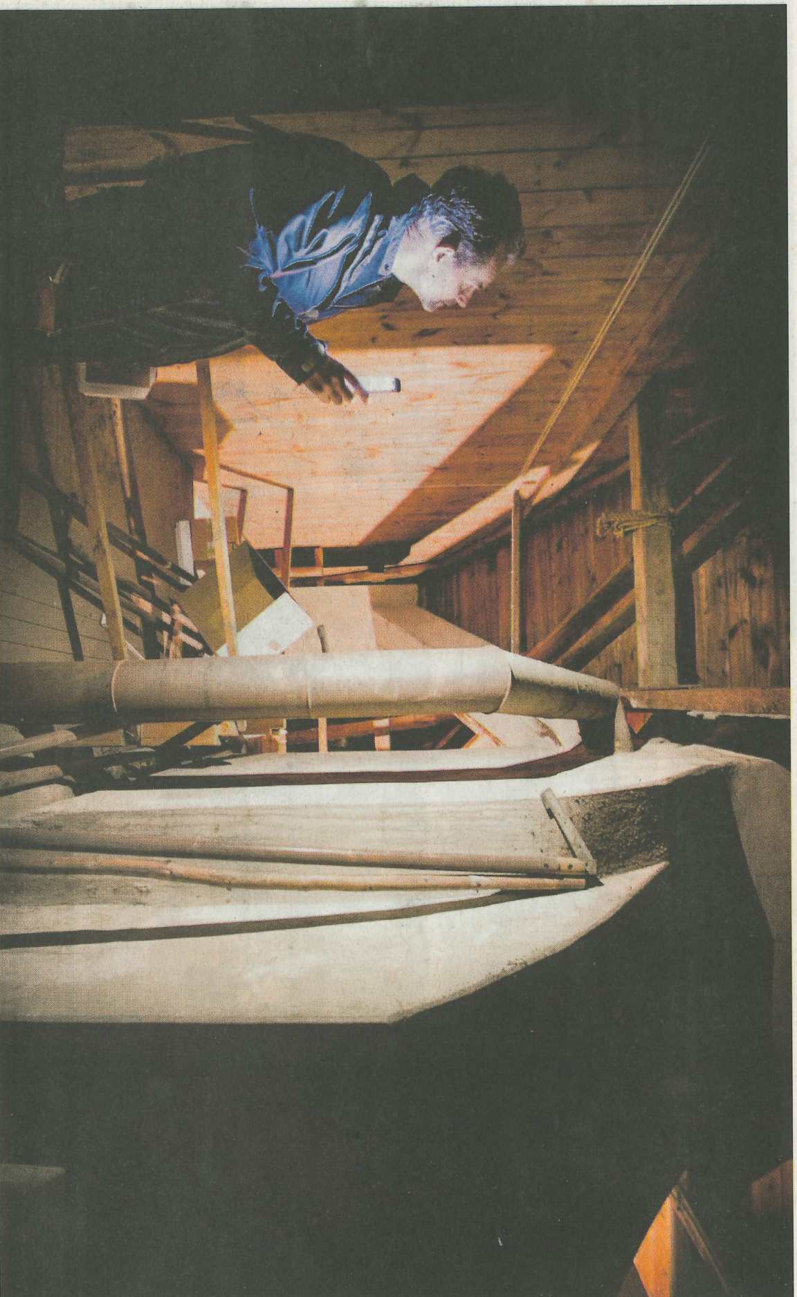
Frisk luft var väldigt viktig på epidemisjukhuset, och är i dag finns den stora ventilationsanläggningen kvar uppe på vinden. "Det är säkert den bäst bevarade anläggningen från den här tiden", säger Örjan Molander och visar de vindlande rören.
