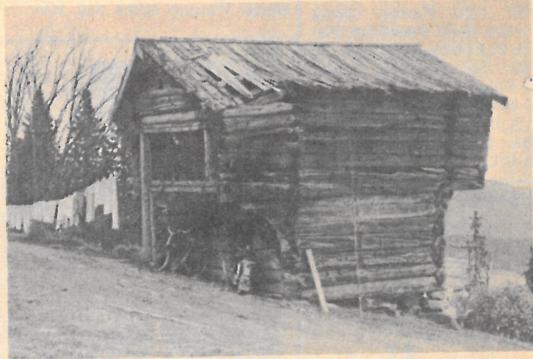
I slik forfatning var det fredede hus før det ble flyttet til museet og restaurert.
