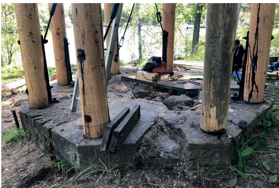
Figur 10. Nederdelen av stolparna är utbytt. De nya stolparna består av svarvat kärnvirke. Stolparna står på tjärpapp. Här syns att stenfundamentet saknar några stenar. Foto: 2020-07-03.
