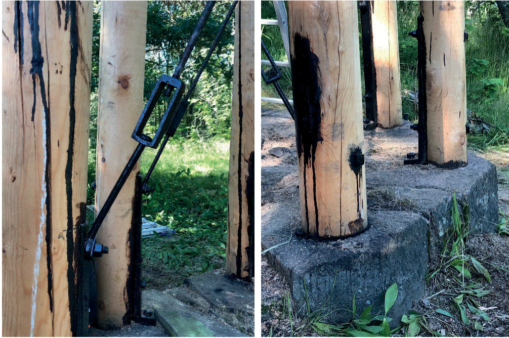
Figur 11 och figur 12. Närbild på de dragstag som håller konstruktionen på plats. Dessa järn sitter på sex av åtta stolpar. Stolparnas skarvar och gängstänger är tjärstrukna. Foto: 2020-07-03.
