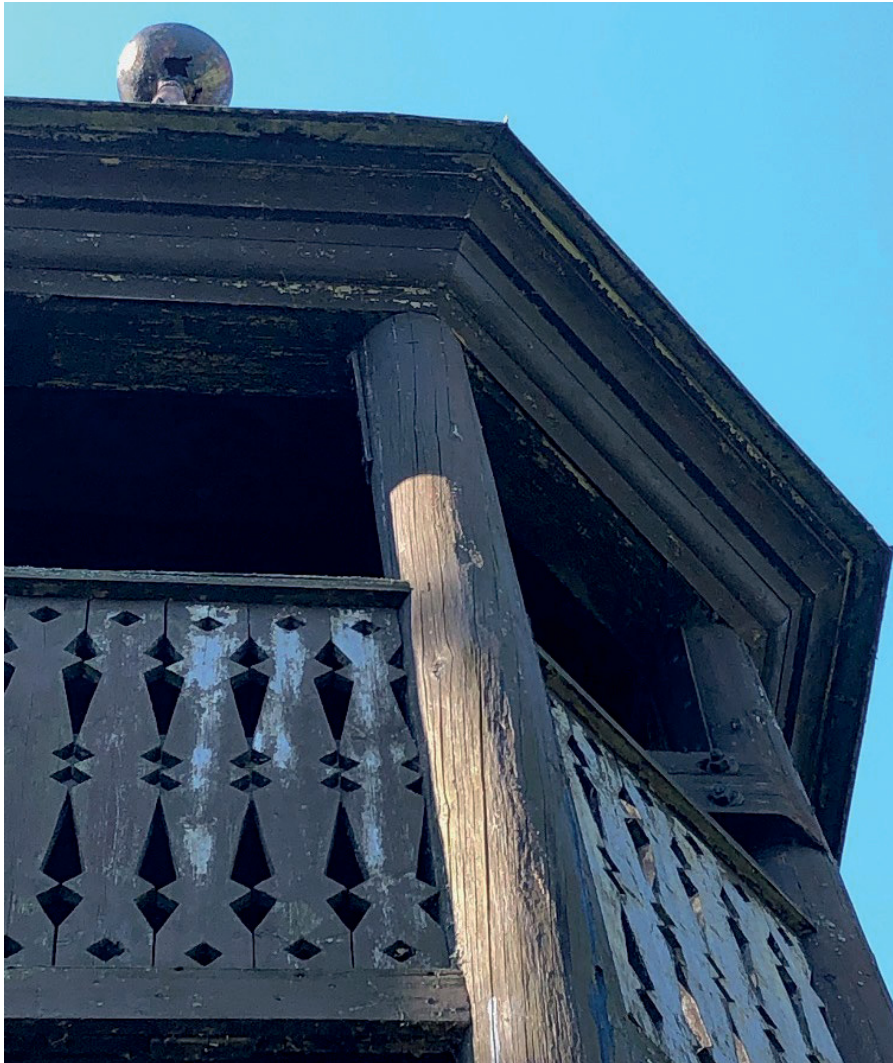
Figur 5. Innan påbörjade arbeten med skrapning. Tidigare färglager flagade. Foto: 2020-07-03.
