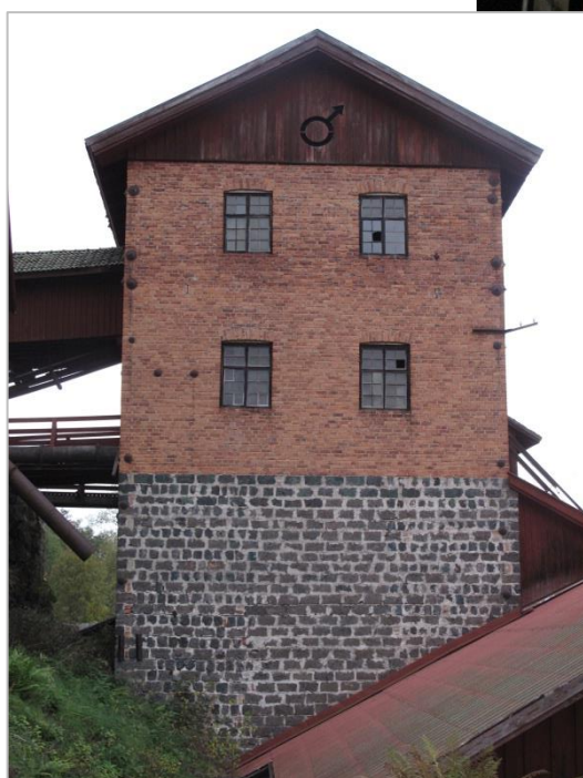
Masugnsbyggnaden. Många fönsterrutor var trasiga.
