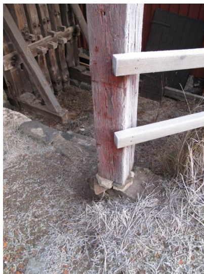
Stolpen på slagstampsdelen som var kraftigt rötskadad, efter åtgärder.
