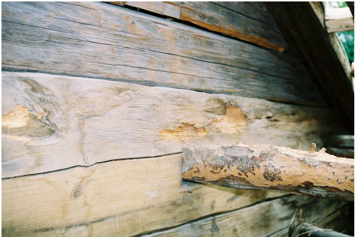
Rötskador i vägen mellan kammaren och stugan
