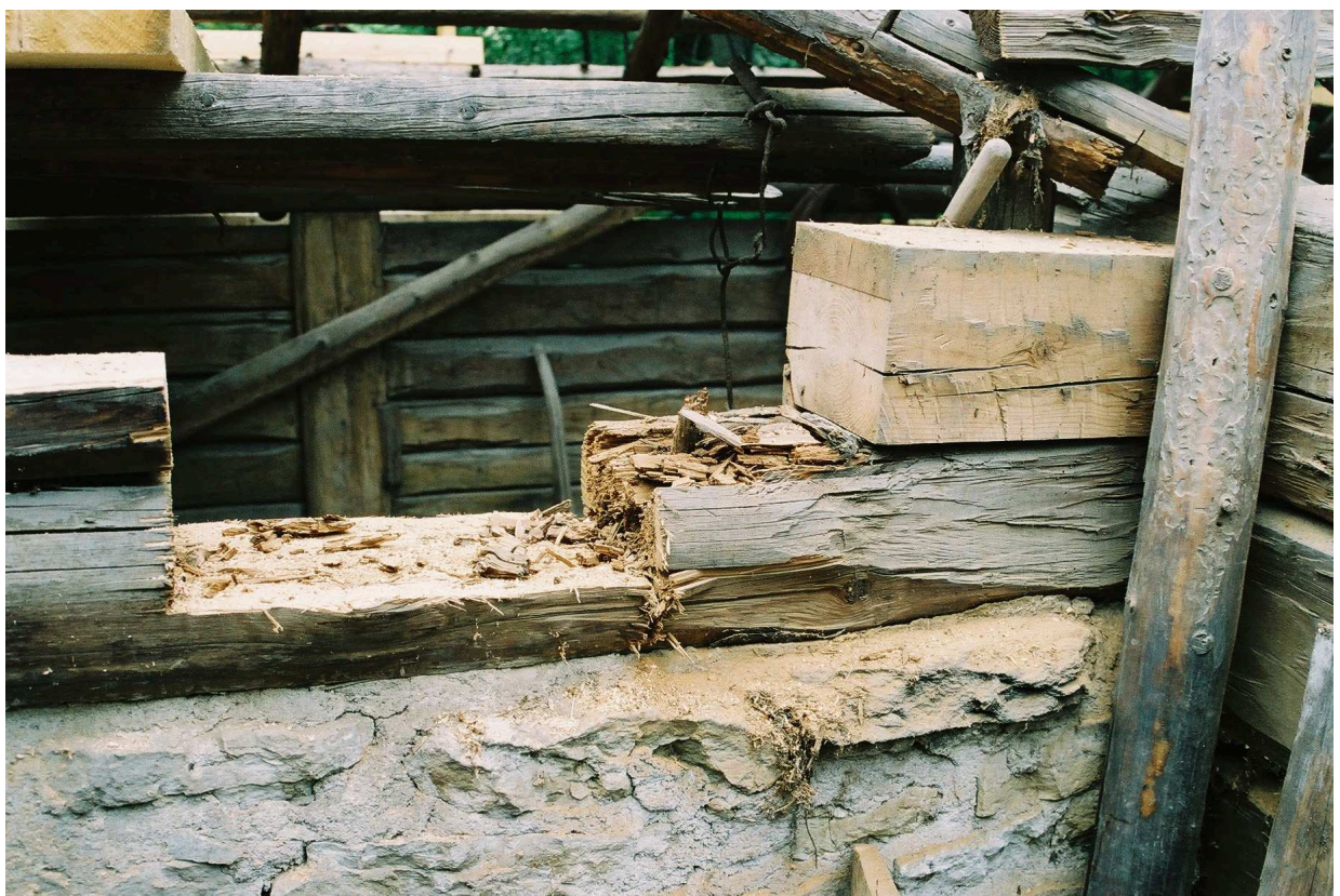
Rötskador i väggbanden mellan fähuset och ladan.
