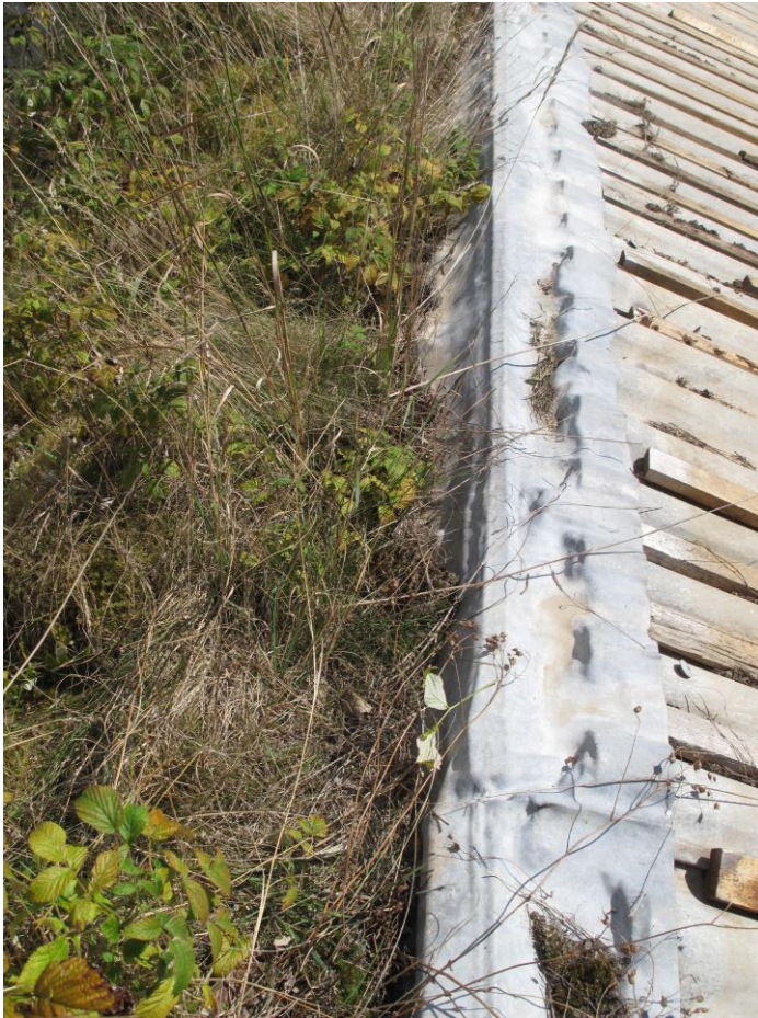
Nocken var täckt med blyplåt. Det syns att torven även på vänstra sidan i bilden, det norra takfallet, är på väg att kana ner.
