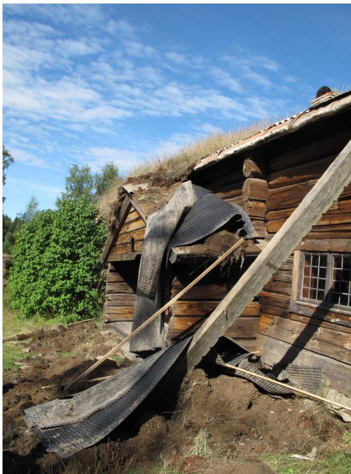
Torven på mitten av taket har dragit med sig platonmattan ner. Mullåsen som ska hålla torven på plats har gått av.
