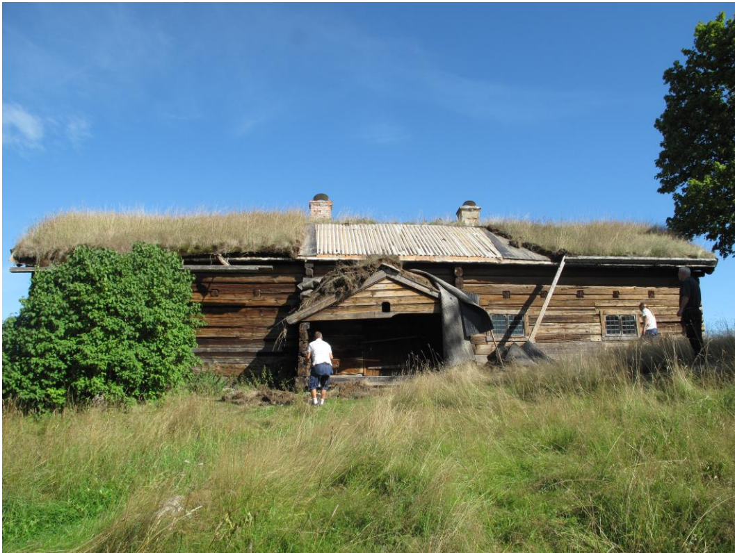
Delar av torvtaket har kanat ner. Under syns platonmatta och eternit.
