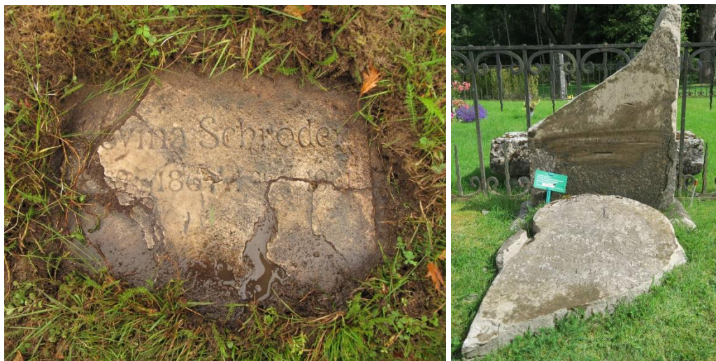
Bilderna ovan visar på olika skador som gravvårdar av kalksten kan ha, vittring, skador efter frostsprängning, sprickor m.m.
