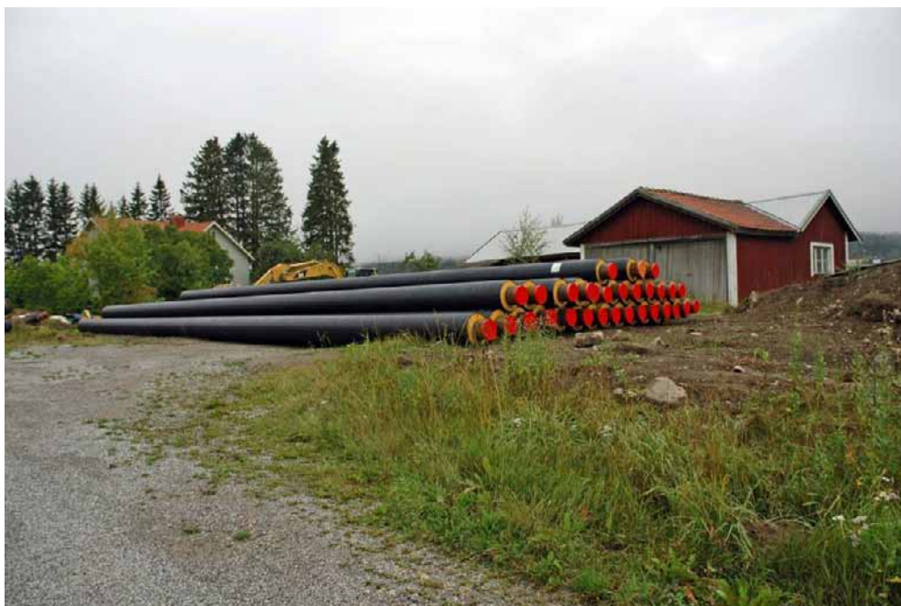
Fig. 15. Fjärrvärmerören på fel plats. Bakom syns garaget och byggnaden som senare revs inför undersökningen.
