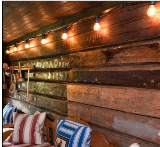
TØMMERVEGGER: Veggene var dekket med panel og plater, og da de ble tatt ned, dukket det opp skrift på veggen.
