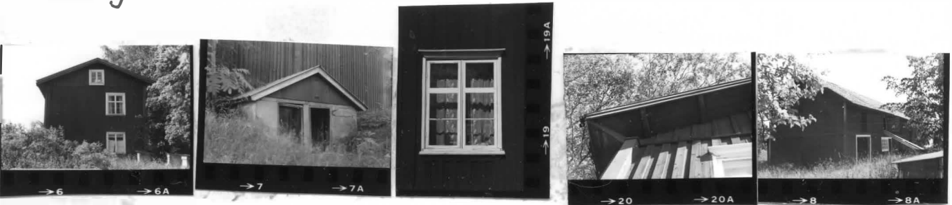
I ö I nö I fönster s I takfot nv II nv
