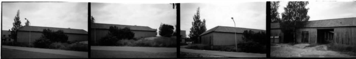
Bod III N Östra delen Bod III N Västra delen Bod III NO Bod III mittpartiet 0
