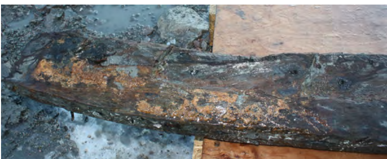
FIGUR 14 ØVRE ENDE AV FORSTEVN BC17 X176. TILHUGGEDE SPENNINGSHAKK FOR MOTTAK AV BORDENDER SYNLIGE. FOTO: KHM
