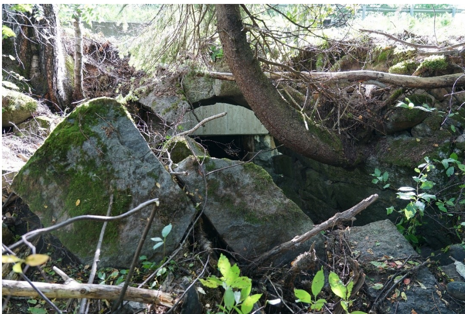
Figur 10. Stenblock i floden, där bron har rasat. Foto från väst.
