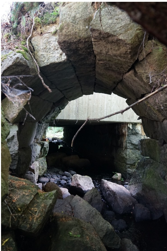
Figur 9. L2024:4211, stenvälv, foto från väst. Taget stående på de lösa stenblocken där bron rasat.
