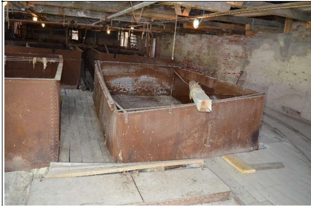
Lutkarene før sikringstiltak. Venstre hjørne på lutkaret midt i bildet har falt ned 30-40 cm på grunn av kollaps i fundament under bæresøyla.
