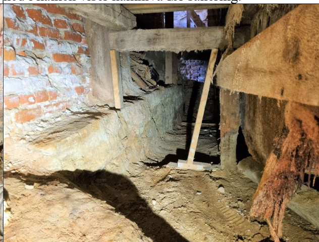
Samme sted etter sanering. (område H) Stolper som bærer gulvet over er skadet av lutråte. Gulvet er midlertidig understøttet i påvente av reparasjon.
