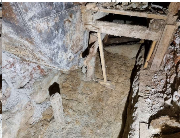
Samme sted etter sanering. Granittfundamentene er avdekket slik at videre forvitring i treverk og tegl bremses. Bærende stolper for gulv er svekket av lutrâte, midlertidige oppstøttinger er satt inn.
