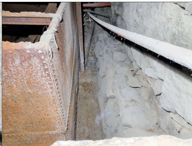
Bilde tatt samme sted etter sanering. Det røde røret øverst i bildet er trekkerør for fiberkabel som ble ført inn gjennom kjellermuren sammen med avløpsrør når huggeriet ble ombygd i 2004.
