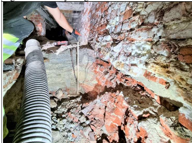
Bilde samme område. Teglsteinen som ble avdekket i veggen var mye av forvitret til rød grus og teglpulver.
