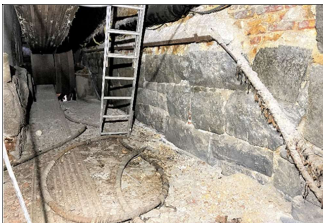
Remkanal, bilde tatt mot vest. (område N) Gulvet er dekket av forvitret mur og pussnedfall fra veggene.
