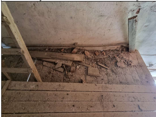
Mikseriloft, nordvegg før sanering. Murpuss fra veggene og annet rask ligger utover gulvene.
