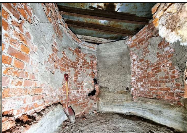
Bilde tatt under mikseritank sør, ferdig sanert. Forvitring av tegl-fundamentene har nok vært et problem i lang tid, teglverket er reparert med betong.
