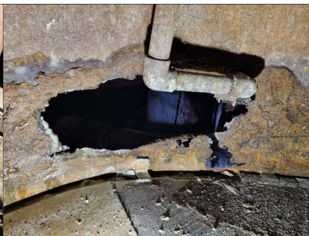
Nærbilde av korrodert hull i tanken. Korrosjonen har vært aller størst i overkant av kalken som har ligget i tanken. Muligens skyldes dette høyt fuktnivå i kalken som har gitt korrosjon her, mens høy PH har beskyttet jernet lenger ned i kalklaget.
