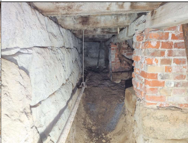
Samme sted etter sanering. I dette området hadde det trengt inn en del svartlut, antatt fra sodahuset. Svartluten har farget kalkrestene mørkt brun.
