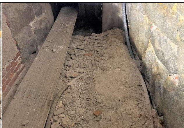
Remkanal, nærbilde samme sted. Ett 5-10 cm tykt lag av mur og puss-rester dekker gulvet.
