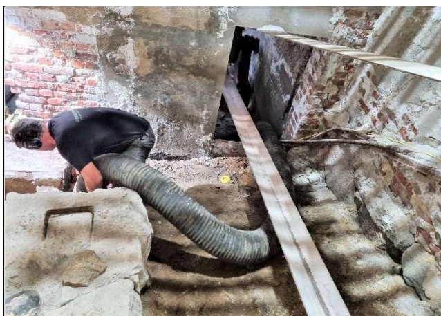
Bilde tatt mot remkanalens vestvegg. (område M) Større mengder sand ligger mot veggen her og fører fukt og salt inn i teglveggen om i sin tur fører til salt og frostforvitring av murverket.
