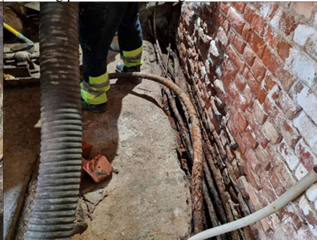
Bilde tatt mot nord langs motorrommets østvegg. (område L) En kulvert for el-kabler langs veggen var fylt opp med sand som kapillært fraktet fukt fra grunnen inn i teglveggen. Sanda er her fjernet. Kablene ble i forkant kontrollert av elektriker. Små merkelapper som forteller om de er spenningsførende eller ei, ble festet til kablene.
