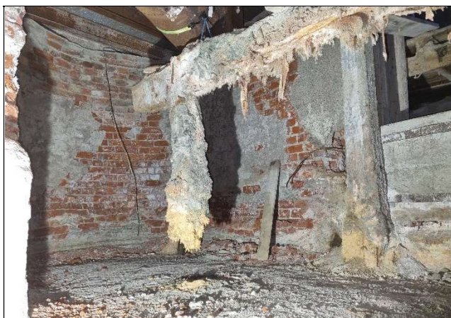
Samme sted som forrige bilde, ferdig sanert. Trebukken som understøtter renna er kraftig påvirket av lutråte, ny bukk må lages.
