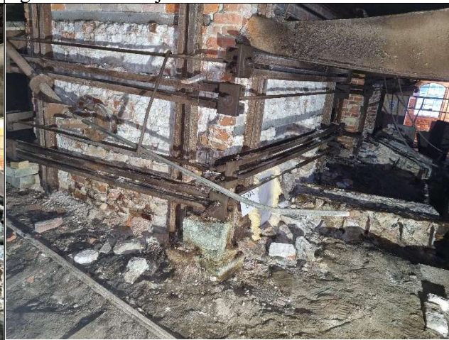
Samme sted etter sanering. Forvitningsnedfall og salt ble fjernet ned til et lag svartstoff. Svartstoffet ble ikke rørt. Det er vurdert til at svartstoffet her har historie og formidlingsverdi og bør bevares slik det ligger. Ved reparasjoner kan det midlertidig fjernes og legges tilbake i ettertid.
