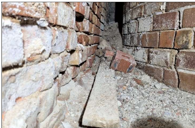
Bilde tatt mellom sodahusets sørvegg og sodahuspipa. Rester av mur og puss ligger mot pipa.
