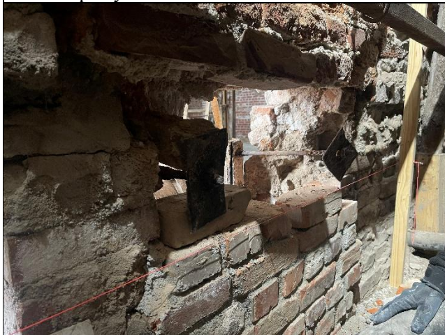
Bilde 3: Festeordningen til ståltanken i fyrhuset gikk gjennom veggen og ble forankret i murverket.
