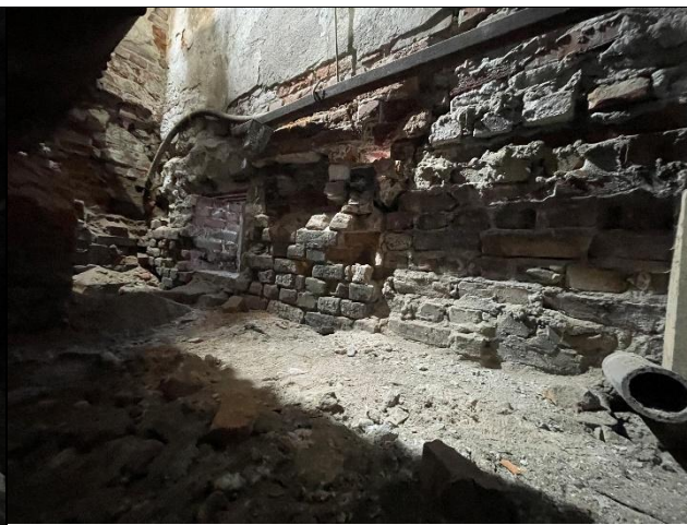
Bilde 2: Murverket er sterkt forvitret. Og 10-30 prosent av veggens tverrsnitt har forvitret vekk.
