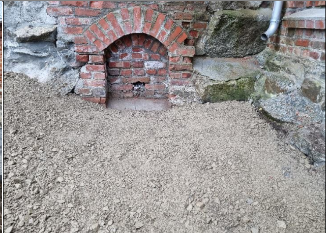
I hjørnet er det murt en bueåpning som fører inn i pipa. En liten firkantet åpning nederst er nok laget for drenering av pipebunnen men er tettet av murrester i dag. Pipebunn og dreneringsåpning bør renses for mur og mørtelrester.
