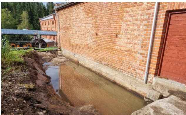
Østside inndamper-tilbygg. Her er det også ei dulp i fjellet som skaper en vanndam inn mot grunnmur. For å spare kostnader med dype fjellgrøfter ble fjellet her «forhøyet» ved å støpe opp ei betongplate.
