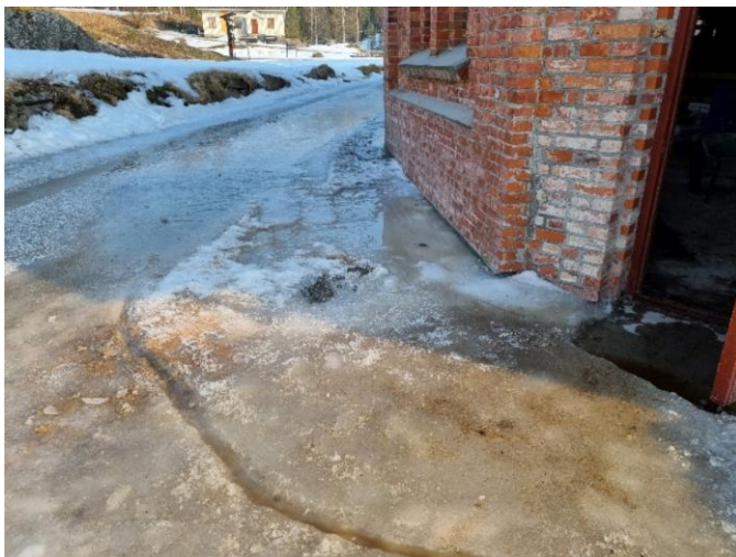
Bilde tatt mars 2022. Her kan en se utfordringene med høyt terreng/veibane og manglende avrenningsmulighet. Vann og is står så høyt på veggen at det rant inn døra til sodahuset. Teglverket står i direkte kontakt med fritt vann som suges inn i teglverket.
