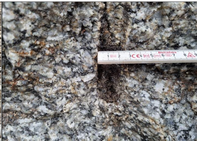
Vaskingen avdekket borehull fra den gang grøftetraseen for avløp fra sodahuskjelleren ble sprengt ut. Det antas at dette må ha vært rundt 1913-14 når nåværende varpeanlegg ble bygget.
