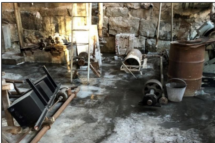
Foto tatt i fyrhuset mot luthuset etter tineperiode mars 2021, gulvet er dekket av is. Vann har trengt inn i luthuskjelleren og beveget seg videre inn i fyrhuset.
