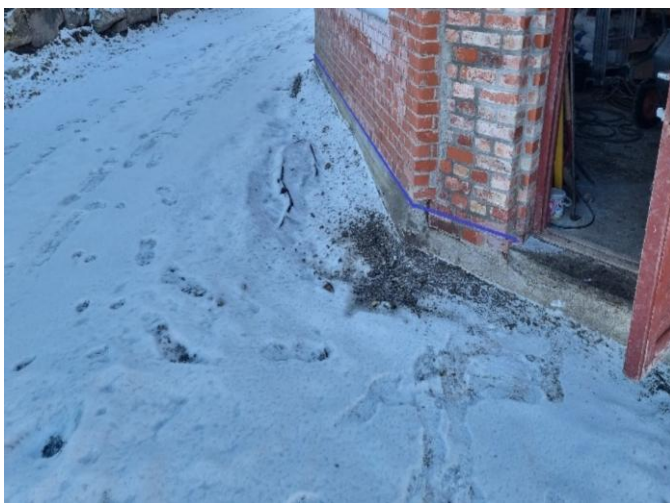
Bilde tatt samme sted november 2023. Vei og terreng er senket. Den blå linja viser nivå på vann og is på ovenstående bilde. Det kanskje viktigste er at det nå er fall på veien videre vestover slik at vannet dreneres vekk den veien.
