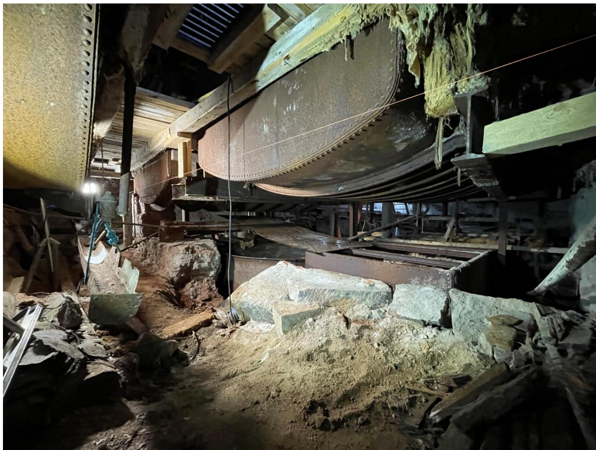
Foto: Anders Nordbakken. Undersiden av sandfiltreringskarene i vest før det ble murt nytt fundament av tegl.
