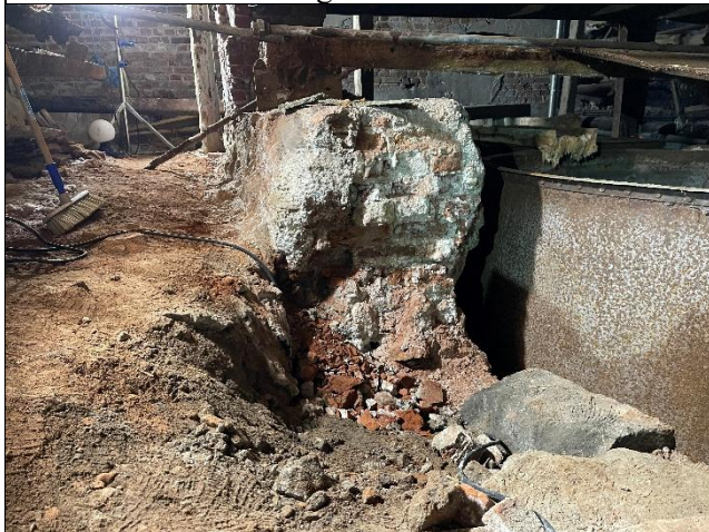
Bilde 5: Opprinnelig fundament støpt i sparebetong. Ca 50 cm av dette måtte pigges vekk pga forvitring.
