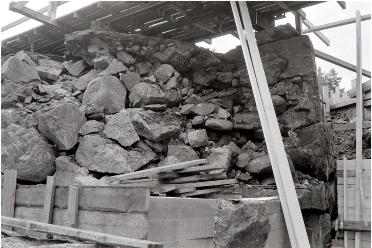
Foto: Klevfos Industrimuseum/Digitalt museum, datert 1989. Deler av dam-muren nord for bunnslua har rast ut. Det ser ut til at ble støpt nye «steinblokker» innimellom gråsteinsblokkene som et «fundament» for re-muring av muren. I høyre bildekant ses forskalingen til betongplata som nå erstatter trebjelkene som tidligere tettet bunnslua.
