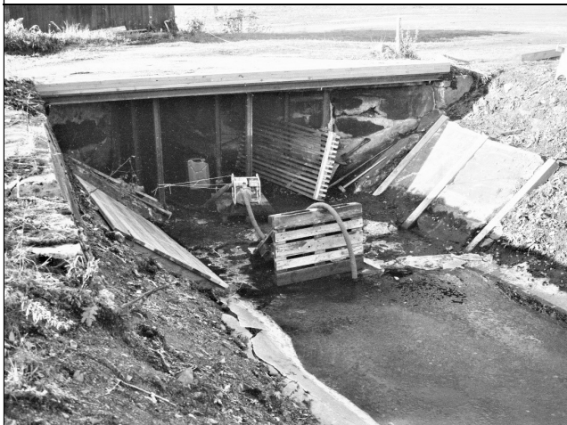
Foto av reparasjoner i 1993. Spikerslagene mellom skråplatene er skiftet ut og den ene er kledd. Nye spilerister er klargjort. De nye sidevangene er ikke støpt ennå
