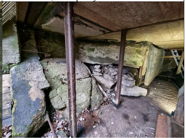
Bilde samme sted, men tatt innover mot vasshuset. Store skader i betongen og blottlagt jernkonstruksjon.
