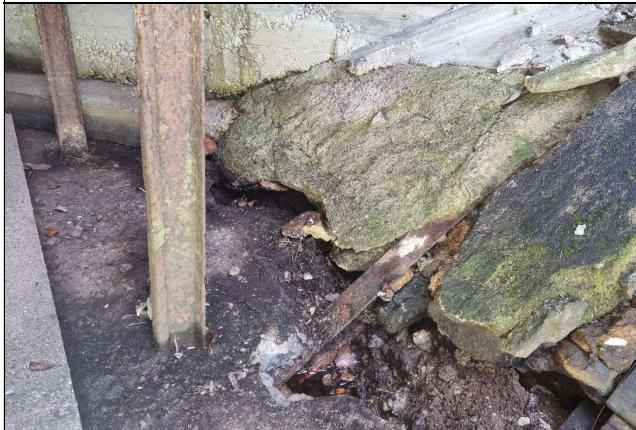
Samme sted, litt annen vinkel. Store sprekker og glipper. Betongveggen fra 1993 er støpt ovenpå den gamle skråveggen. Fugeskum i sprekken viser at lekkasjene har vært et kjent problem.
