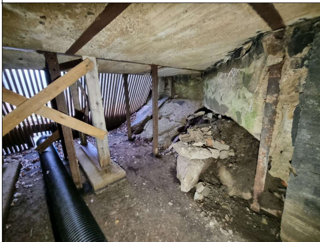
Bilde av den søndre traktutvidelsen. Deler av skråveggen har kollapset og rast ut. Betongen i veggene er generelt i dårlig forfatning, mens betong i tak er i tilfredsstillende stand.
