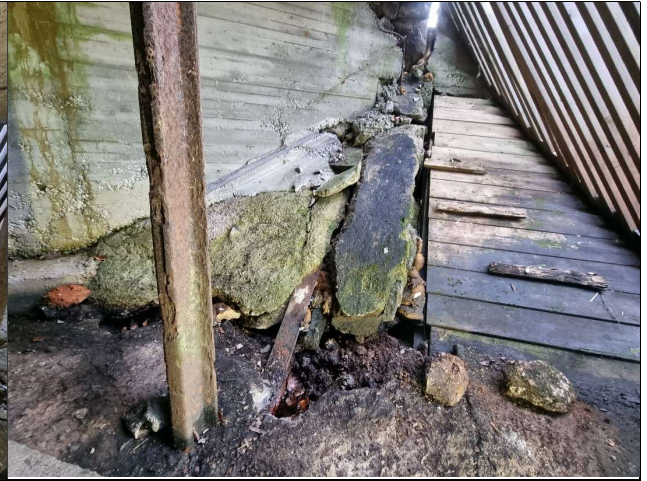
Bilde tatt mot nord i overgang mellom kulvert og inntaksrist. Betongen i de gamle skråveggene er kraftig forvitret med større hull og sprekker som gir lekkasjer. Jernkonstruksjonen er blottlagt og utsatt for korrosjon.
