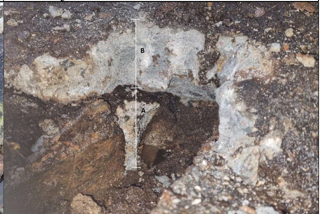
Nærbilde samme sted. Gulvet i kulverten har to lag betonggulv. Det nedre er i dårlig stand og det antas at det ikke lenger beskytter jernet i konstruksjonen. Det er sannsynlig at det øvre laget har kommet til i museumstiden, ved reparasjonen i 1993 eller i 1999.
