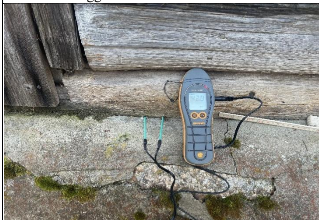
Bilde 9: Fuktmåling av bunnstokk utført i NV hjørne viser 43% RF 3 cm inn i tømmeret. Den sementbaserte hulkilen på topp murkrone må meisles vekk.
