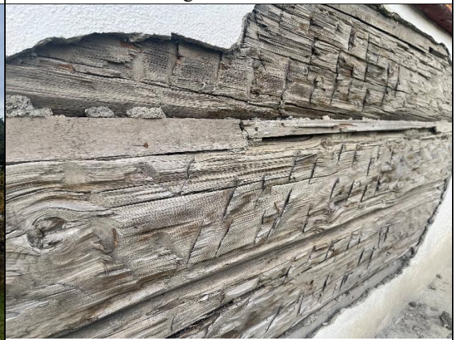
Bilde 6: Skadebilde SØ. Skavhugg er benyttet for å få rappen til å hefte seg til vegg. Her har rappingen fra 2001 forvitret av vegg.
