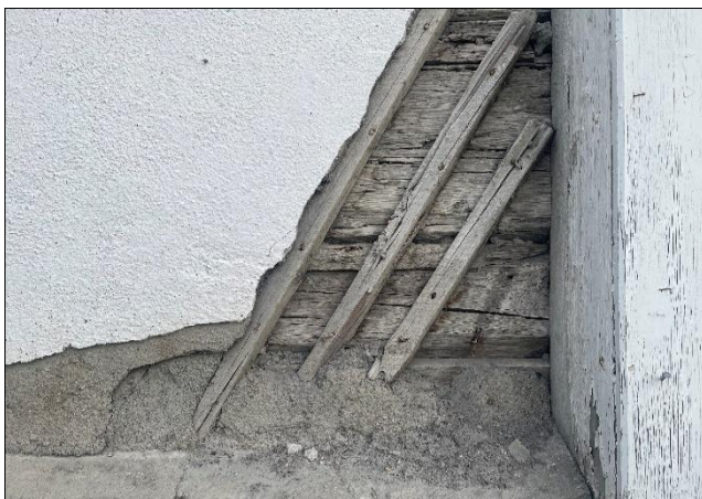
Bilde 7: Skadebilde S. Spiler er benyttet som festemetode for leirerappingen. Rapping utført i 2001 forvitrer av veggen.
