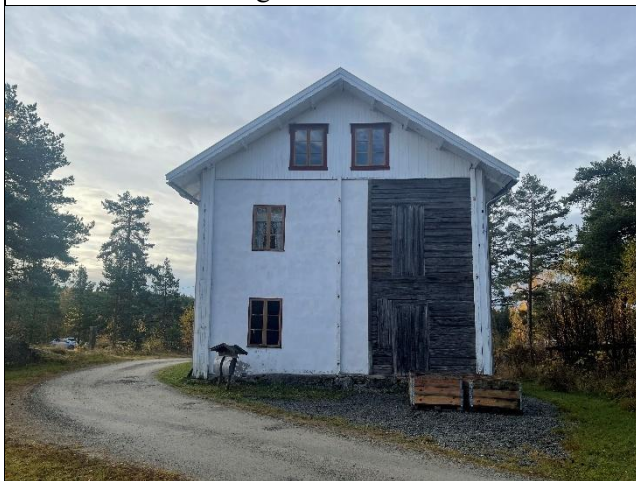
Bilde 5: Arbeiderboligen N. Fasaden har blitt påført en sementpuss på hønsenetting.
