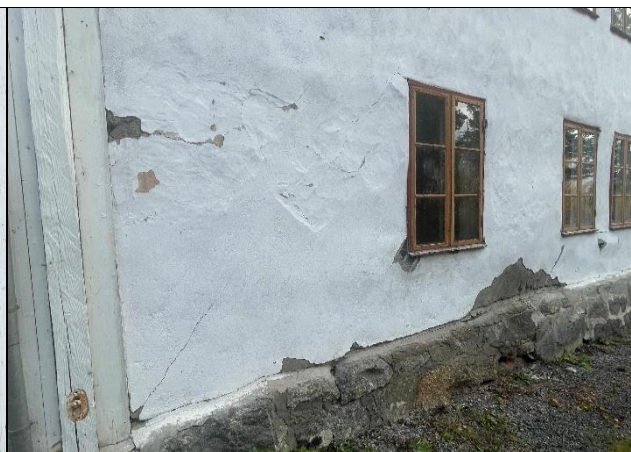
Bilde 8: Vestveggen har behov for vedlikehold. Her sees sprekker i rappen. Tynnpussen har enkelte steder begynt å flasse av rappingen.
