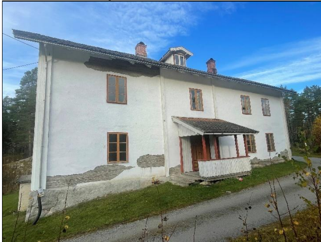
Bilde 1: Arbeiderboligen Ø. Rappingen forvitrer av vegg. For å stoppe forvitringen må rappingen istandsettes. Rappingen er påført skavhugg.
