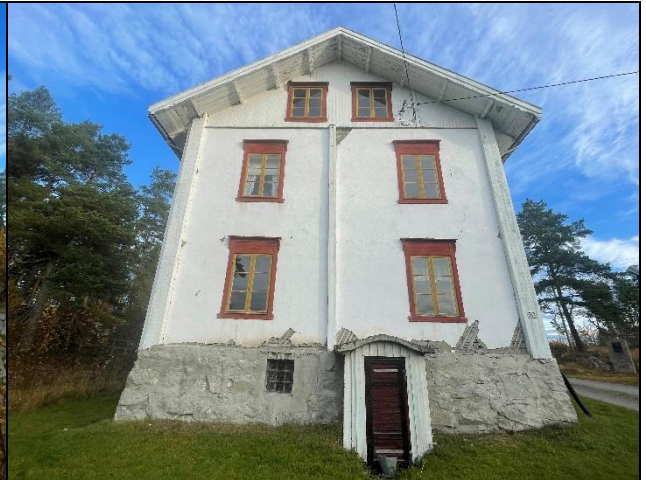
Bilde 2: Arbeiderboligen S. Rappingen forvitrer av fasaden, men omfanget er mindre enn på østveggen. Rappingen er påført spiler.
