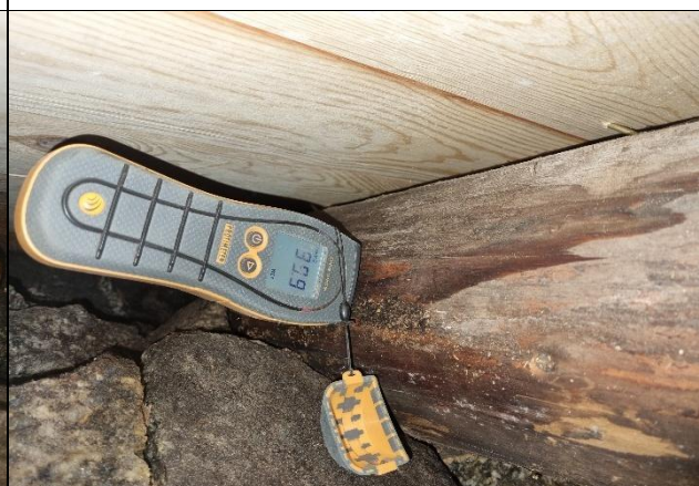
Bilde 12: Fuktmåling av gulvås mot Ø. Også her måles RF til 100%. Årsaken skyldes vanninnsig og fuktig grunne i krypkjelleren. Tiltak med dampsperre og lufting vil bedre forholdene.
