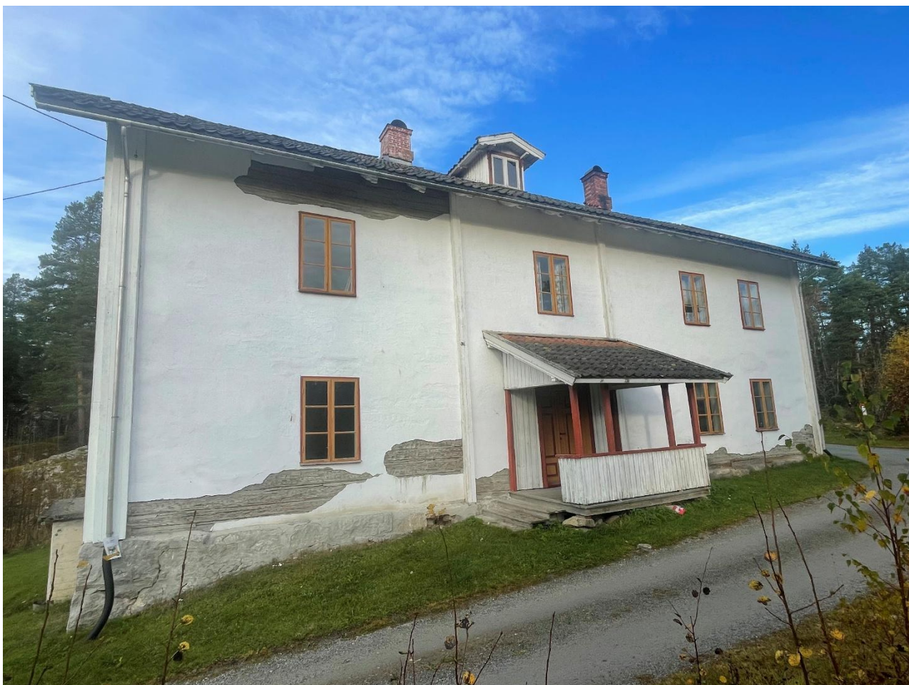
Foto: Anders Nordbakken. Arbeiderboligen sett mot øst. Store partier med leirerapp forvitrer av fasaden. Forvitringen er pågående og leirerappen må istandsettes for å stanse forvitringen.
