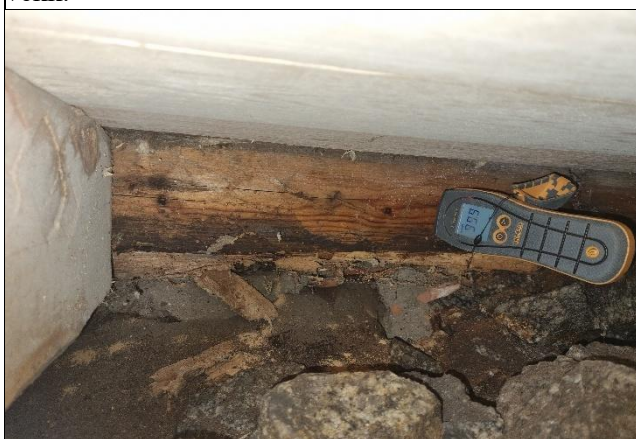
Bilde 11: Fuktmåling på bunnstokken i krypkjelleren mot Ø viser 100 RF. Tiltak med dampsperre på grunn, og bedre utlufting av kjeller må iverksettes så fort som mulig.
