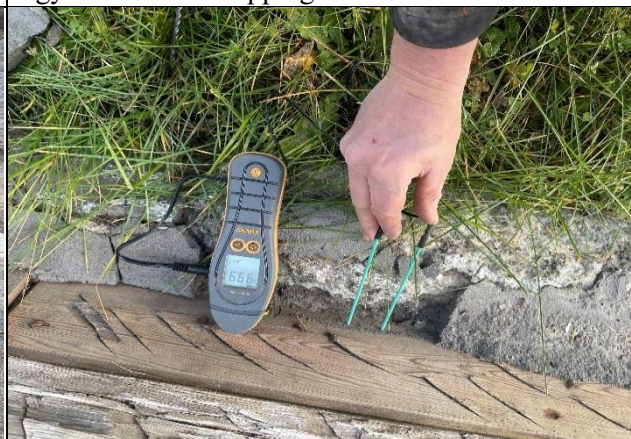
Bilde 10: Østvegg mot nord. RF i bunnstokken måles til 100%. En rekke tiltak anbefales i tilstandsvurderingen for å bedre forholdene.
